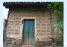
Figure 14. PdC - 'Piedra de Cantero' Mampostería hecha de piedras de cantera, confinadas con madera.
