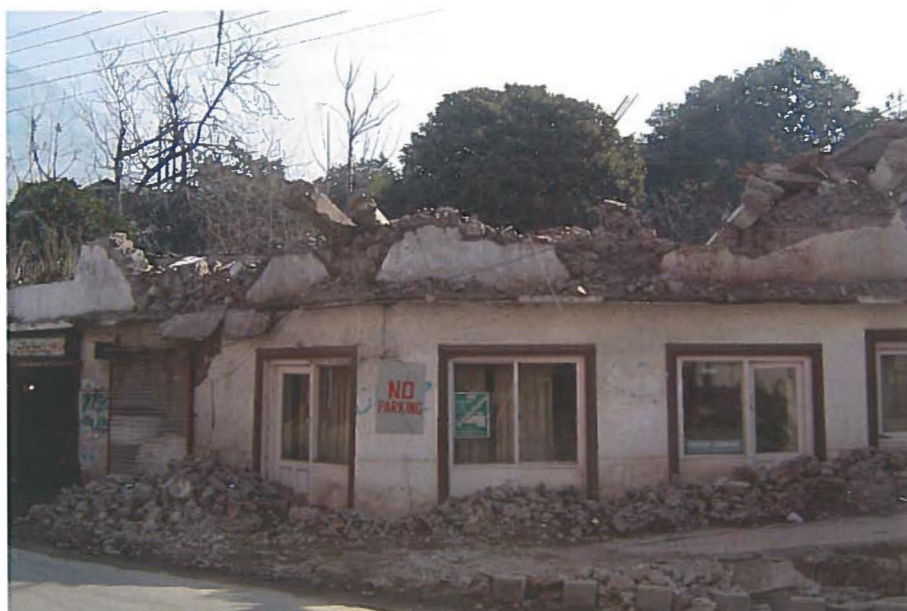
Svake bygningskonstruksjoner er hovedårsak til skader. Poor construction practice is one of the main factors causing damage.
